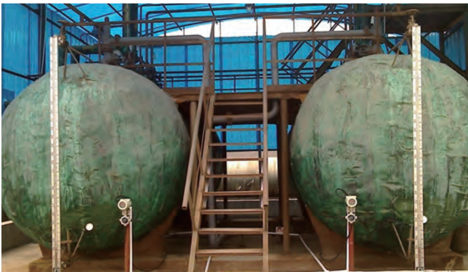
外测液位计现场安装图
